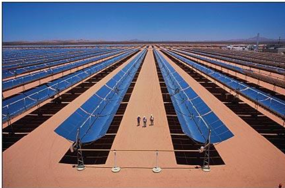
Campo de concentradores solares de canal parabólico
